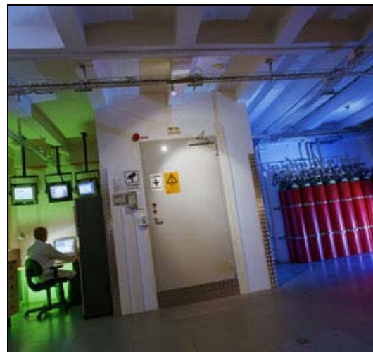
Bahnhofs serverhall, Norra Stationsgatan, Stockholm
