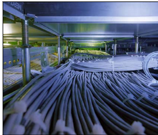
Mer än 40 km datakabel finns i Bahnhofs serverhall på Norra Stationsgatan. Bolagets filosofi är att tillhandahålla tung infrastruktur (för datacenter) i storstädernas citykärnor. Det ökar tillgänglighet och prestanda ur ett kundperspektiv. Bahnhof har idag fem datacenter i Sverige – med ett sjätte under prospektering i centrala Stockholm.
