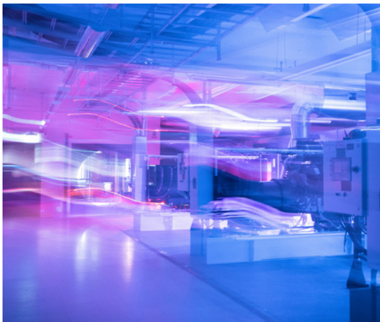
Datacentret Gullan i Kista.
