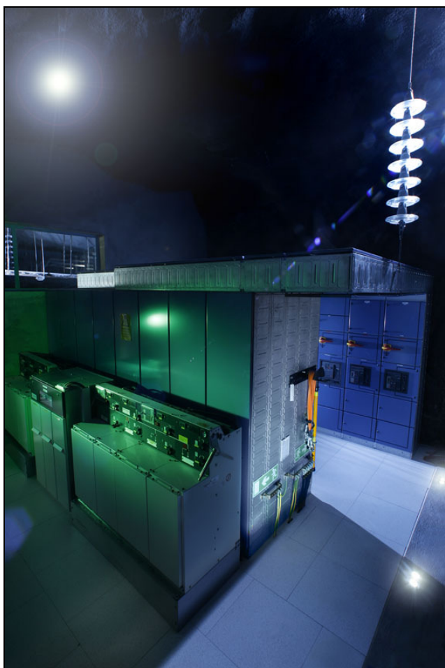
Ställverket för anläggningen "Pionen"
